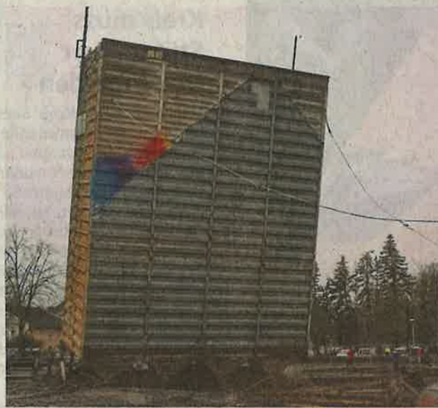
Die Stahlträger knicken ein, Sekunden später ...
